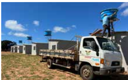
PROGRAMA CASA SOLIDÁRIA. Está em obras o maior programa habitacional da história de Mineiros, com recursos 100% do município. Nesta primeira etapa estão sendo construídas 500 moradias, que serão destinadas, a custo zero, para famílias de baixo poder aquisitivo.
